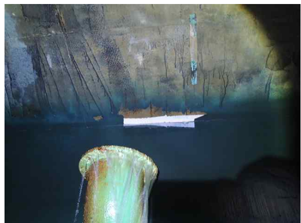
[배수지 1호지 상부슬래브 : 도장손상]
