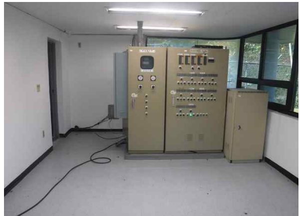
[현장제어반 작동 상태양호]
