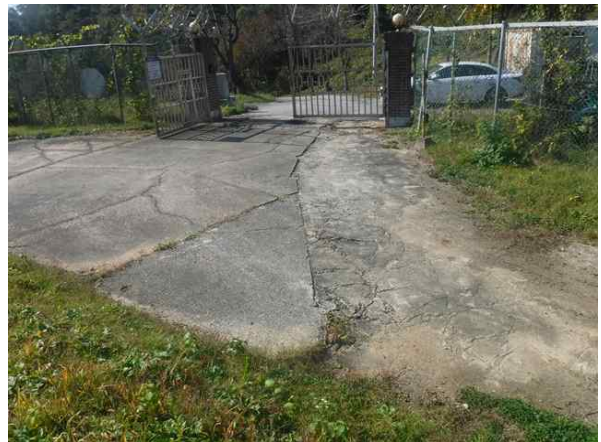
[구내도로 : 포장콘크리트 균열]
