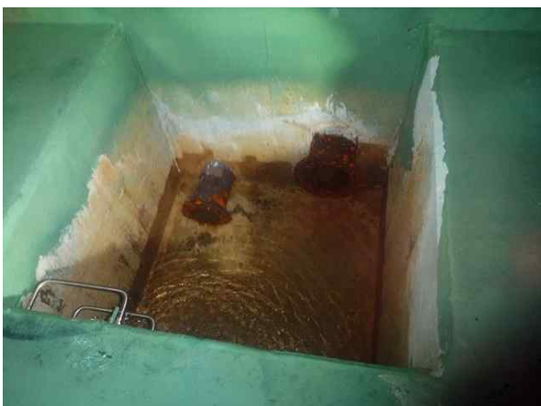
[배수지 1호지 바닥슬래브 : 도장박락]
