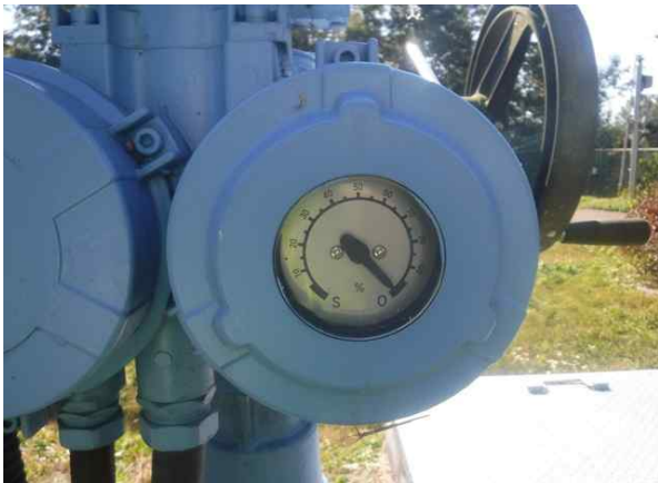
[전동밸브 계도계 상태양호]
