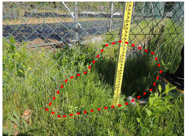
[펜스 : 능평망 일부 파손]
