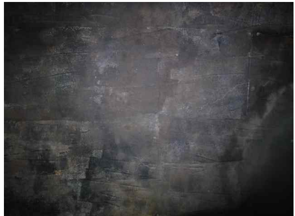
[배수지 2호지 상부슬래브 : 망상균열]
