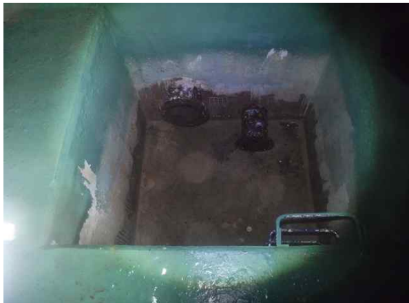
[배수지 2호지 바닥슬래브 : 도장박락]
