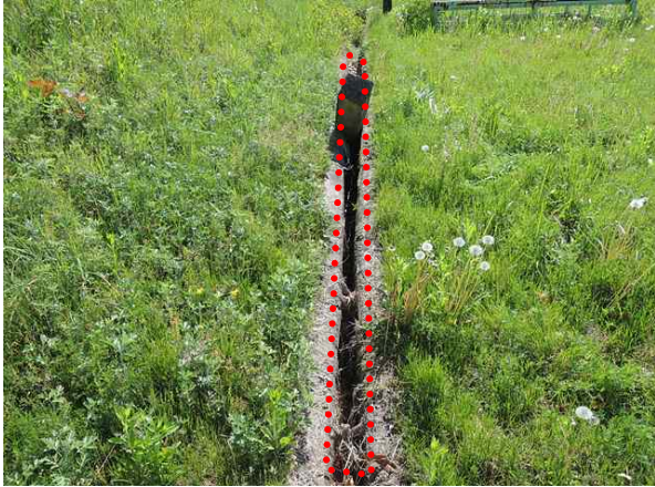
〔배수로 : 전도 및 파손〕
