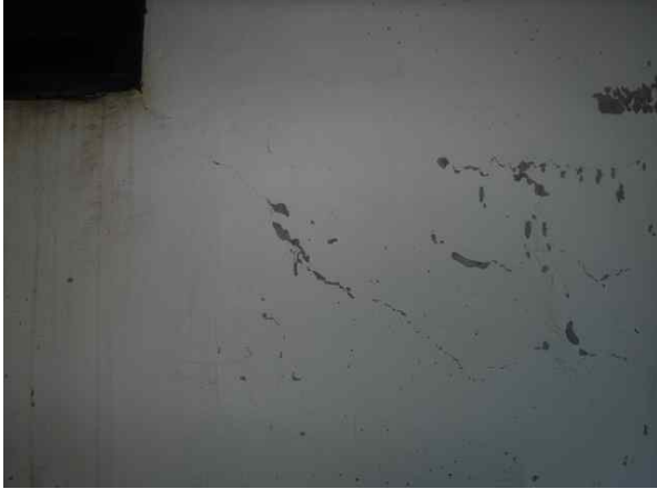
[검수실 : 벽체 균열]
