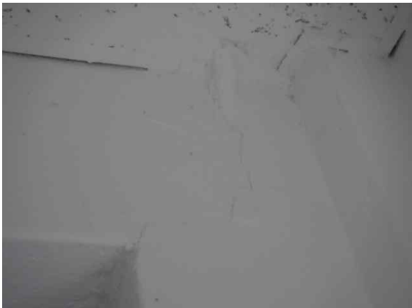
[전기실 및 관리동 : 균열]
